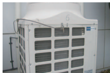
省電力装置「エネカット」を取り付けた室外機
